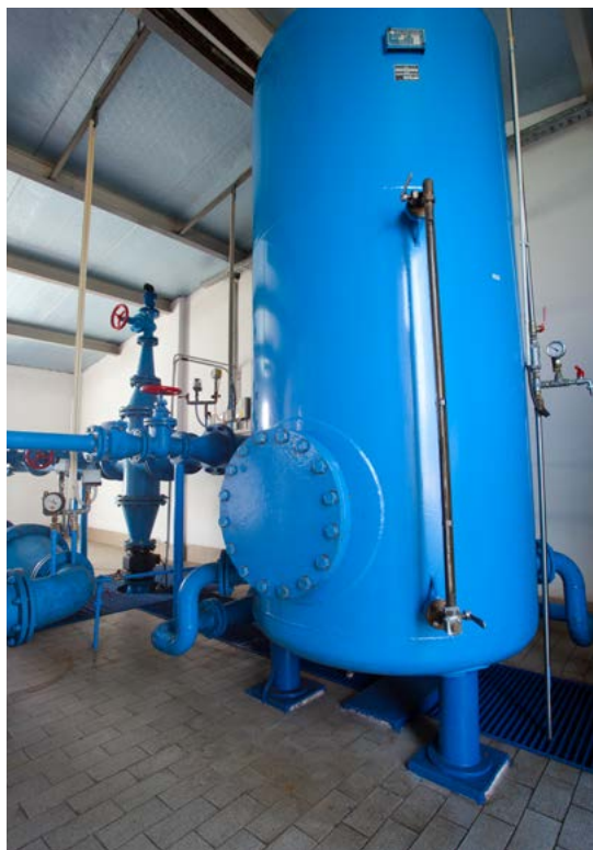
Tlačna posoda v vodovodnem objektu
